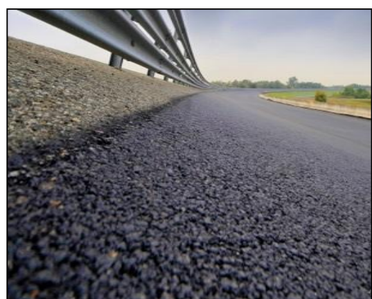
Figura 5: Segregación por materiales defectuosos.
